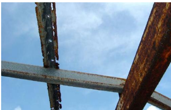
Corrosion of top hat batten
