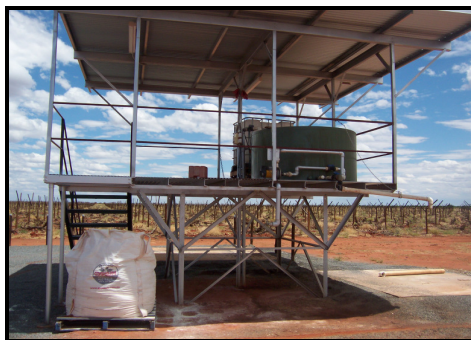
Hình thí dụ một Hệ thống Reciprocating Pump Injection được lắp đặt tốt
