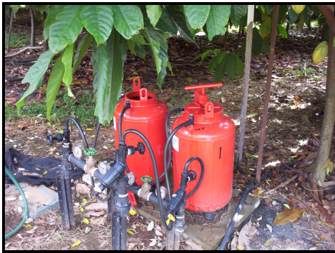
Hình Hệ thống Xịt Venturi Injector
