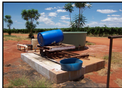
Hình thí dụ một Hệ thống Reciprocating Pump Injection được lắp đặt không đúng cách
