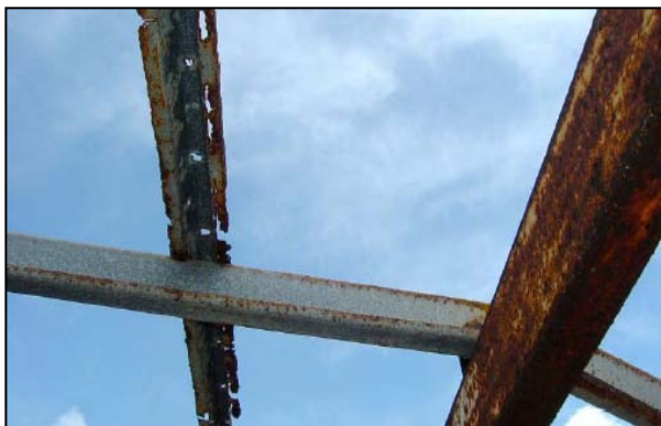
Corrosion of top hat batten
