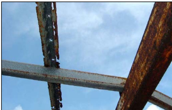
Corrosion of top hat batten
